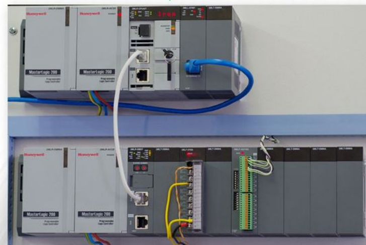
Контроллер с модулями ввода-вывода
